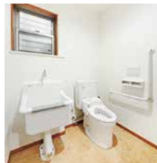
1F 多目的トイレ
